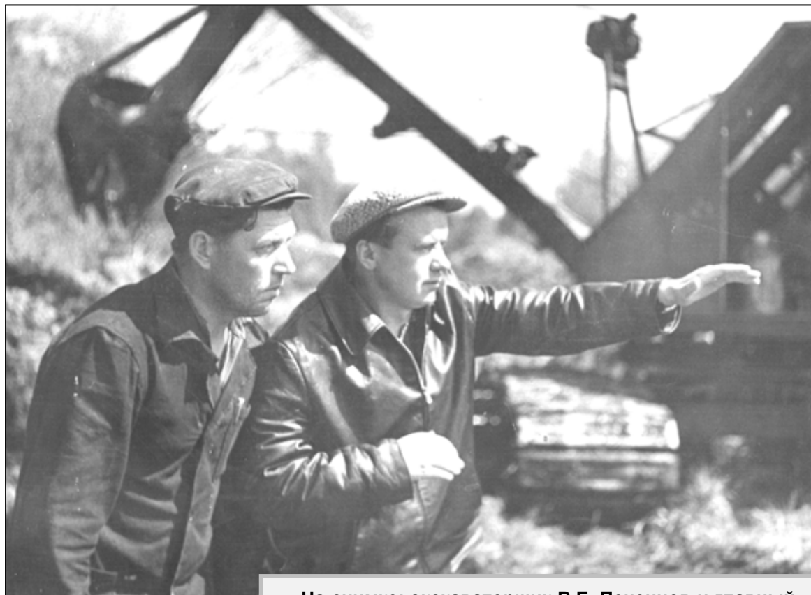
На снимке: экскаваторщик В.Е. Печенцов и главный инженер В. И. Попов планируют работу по осушению торфяного болота около деревни Иловец.
