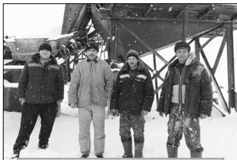
Бригада, задействованная на разборке линии двойной промывки: мастер Сергей Максименков, водитель Алексей Юдачев, сварщик Виталий Морозов, слесарь-дробильщик Владислав Леонов.
