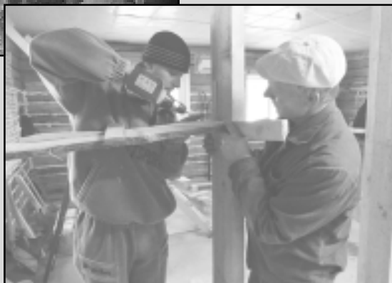
Мастер-строитель ООО «СпасДорСтрой» Юрий Бруй и его подручный Дмитрий Мозайков занимаются реконструкцией офисных помещений в здании конторы. Ремонт идет полным ходом.
